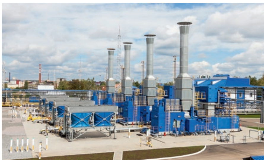
Газоперекачивающие агрегаты Московского УПХГ
